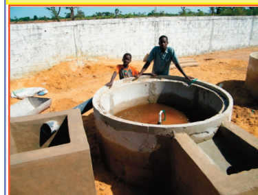
Unité de biogaz terminée
